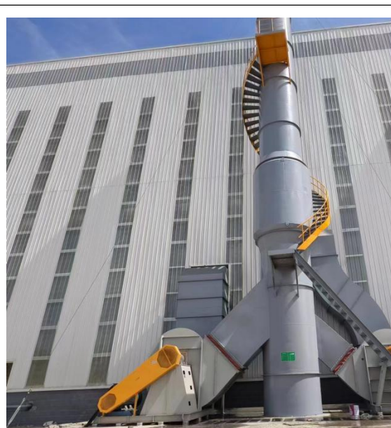
落砂废气排气筒
